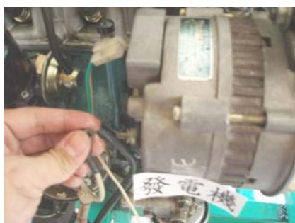
圖 3-4-16 拆開發電機的插座及 B 線頭
